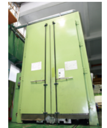
● 変圧器コイル乾燥炉
