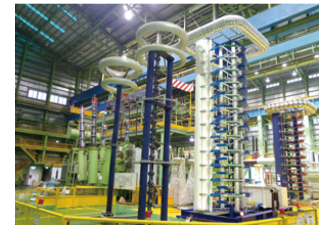
● インパルス電圧発生装置
