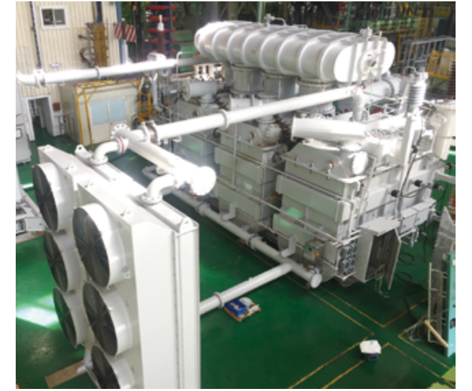
▲ 油送風冷式変圧器
