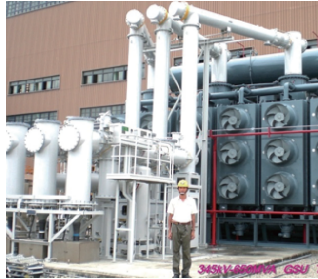
▲ 火力発電用油入変圧器
