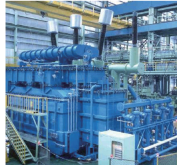
▲ 油入水冷式変圧器
